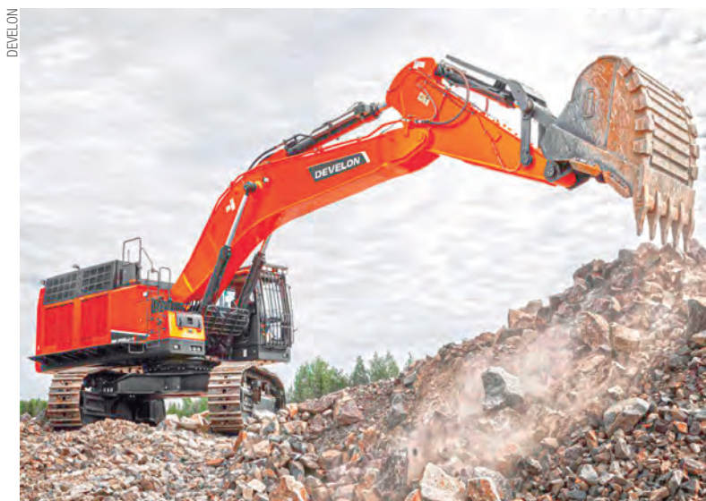
Com motor de 354 kW , a escavadeira Develon DX800LC-5B promete evitar o tempo de inatividade
